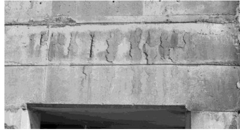
かぶり不足と中性化による剥落
