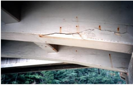
劣化によるひび割れ発生
